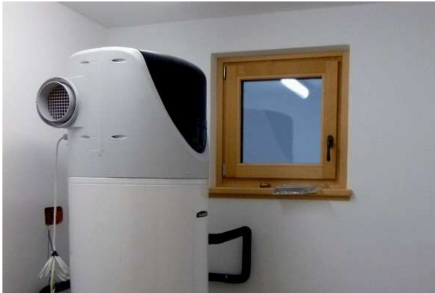
Termocamino a pellet e boiler pompa di calore
