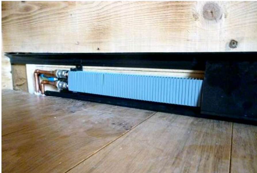
Battiscopa radiante ad acqua ed elettricità
