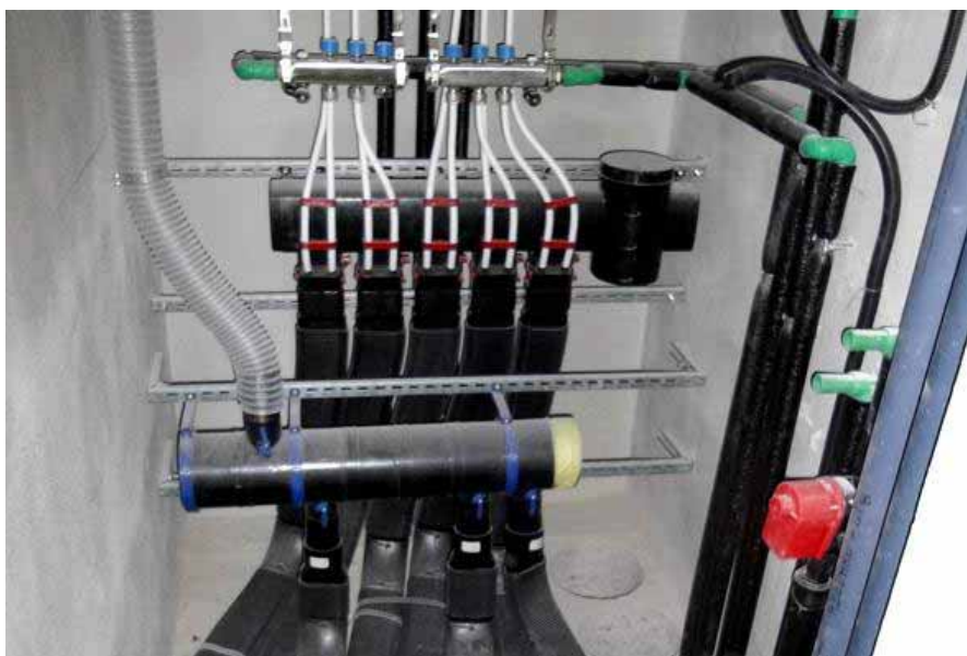
Pompa di calore aria-aria e collettori VMC
