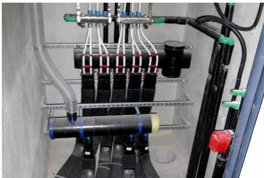
Pompa di calore aria-aria e collettori VMC
