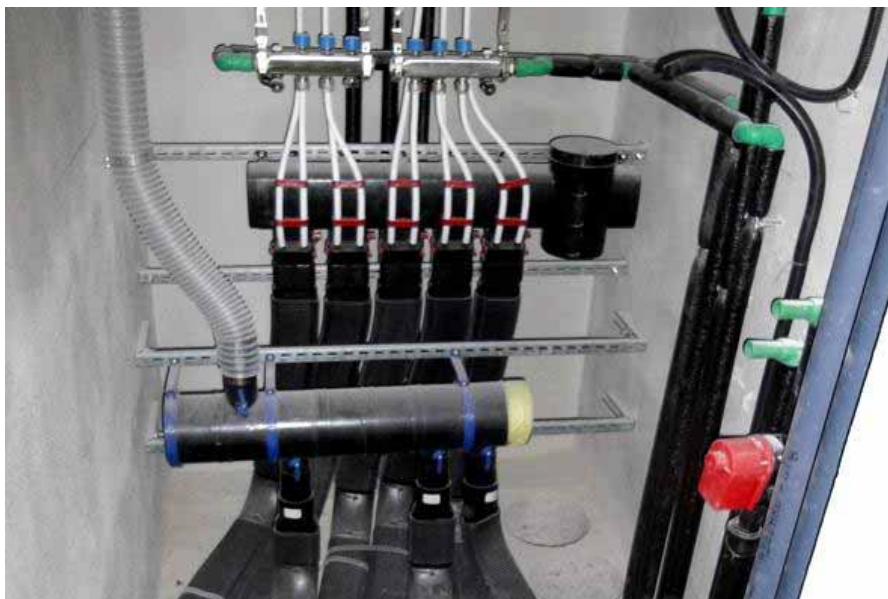
Pompa di calore aria-aria e collettori VMC
