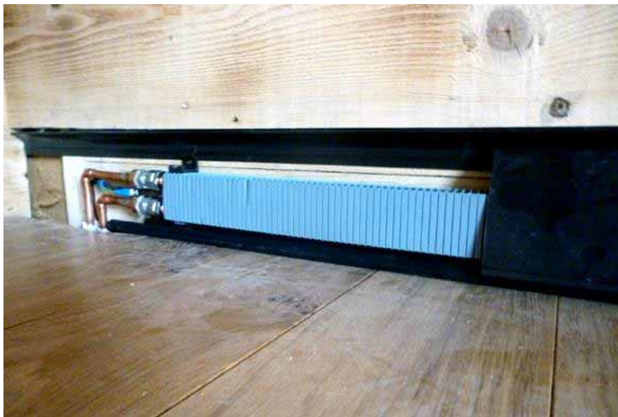
Battiscopa radiante ad acqua ed elettricità
