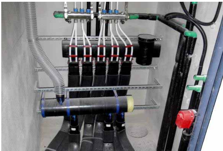
Pompa di calore aria-aria e collettori VMC
